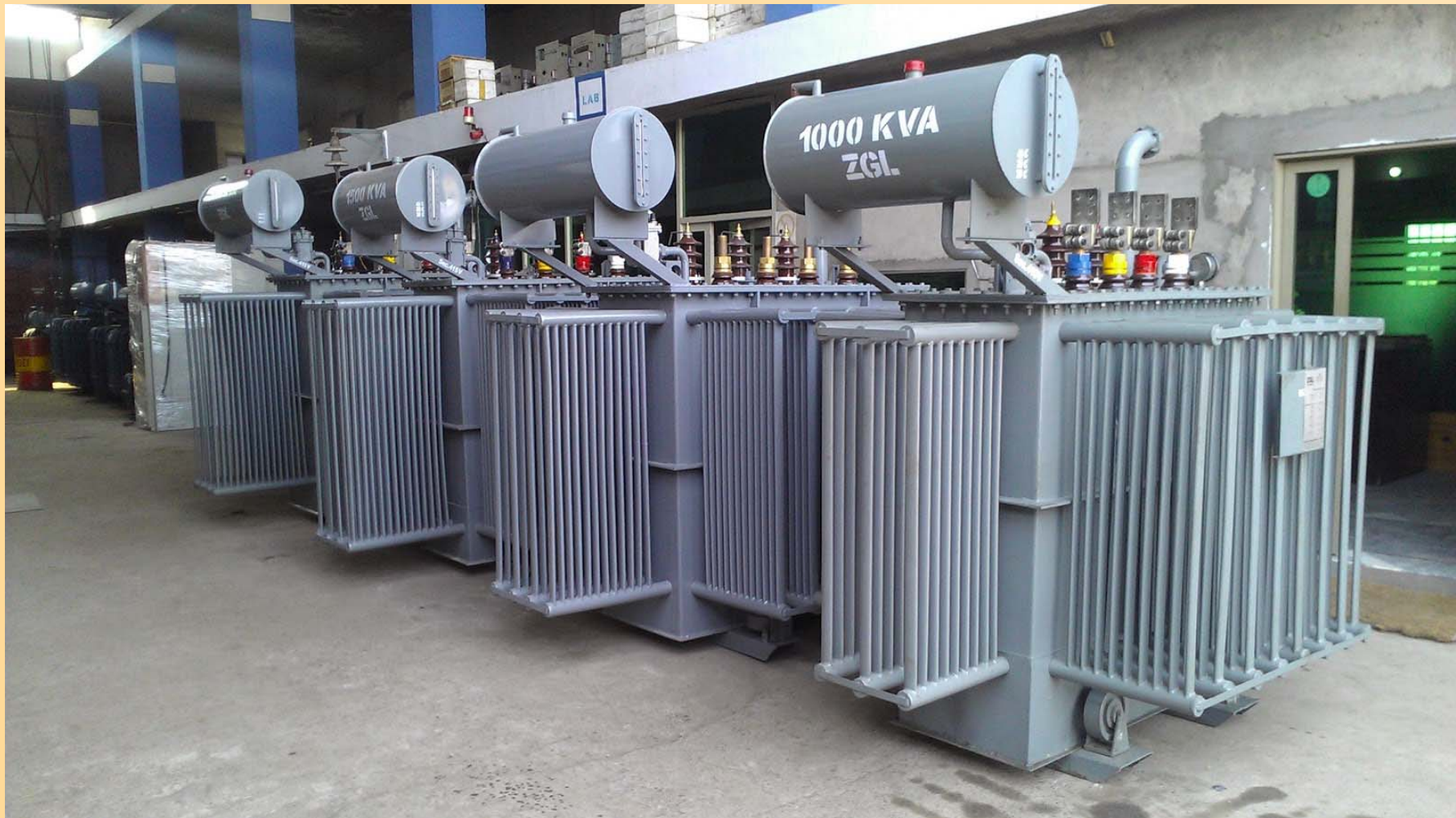
Transformatoare de putere (1000 kVA) cu ulei si răcire naturala prin țevi
